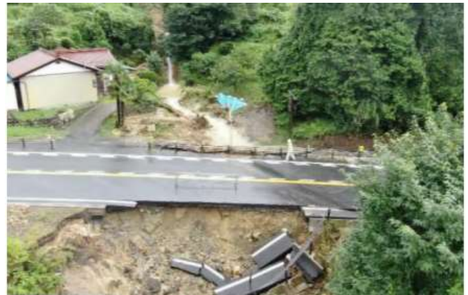
図2※ 令和3年8月豪雨被害状況
